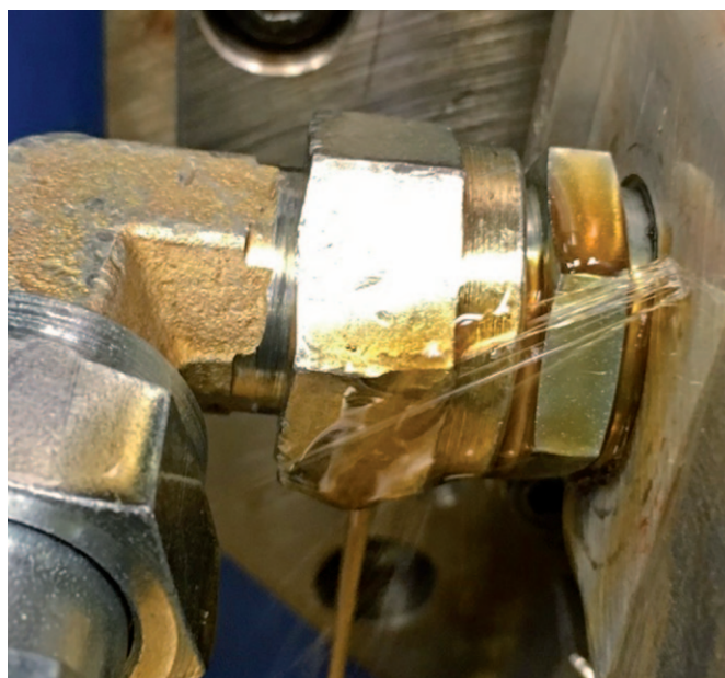
▲ Příklad úniku oleje prasklinou v tělese čerpadla P23
